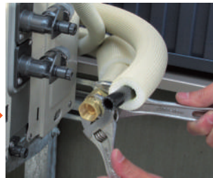
ホース・継手接続
